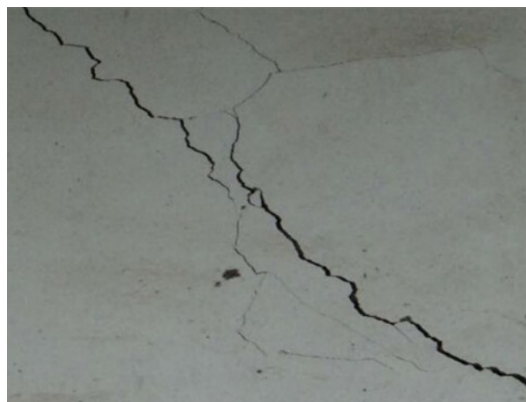
图1 温度变化引起的混凝土裂缝
