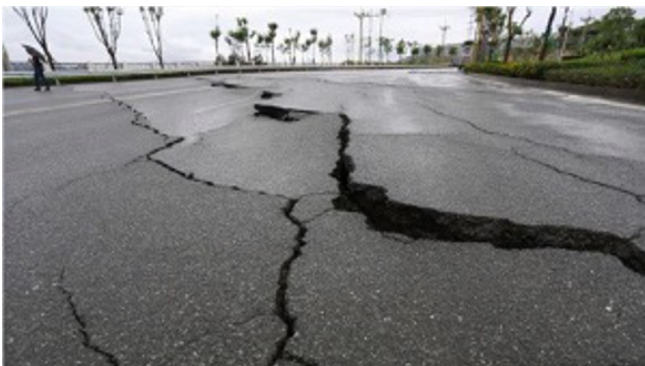
图1 常见市政道路施工中沉降道路图
