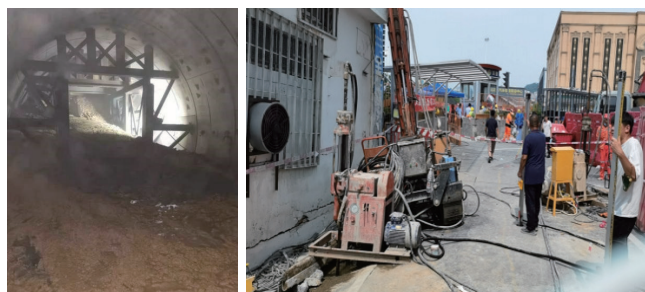
图1 左线隧道内坍塌和地面注浆现场情况图
