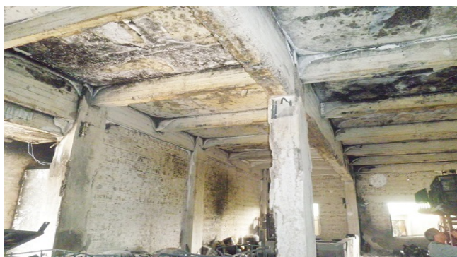
图1 建筑物结构老化
