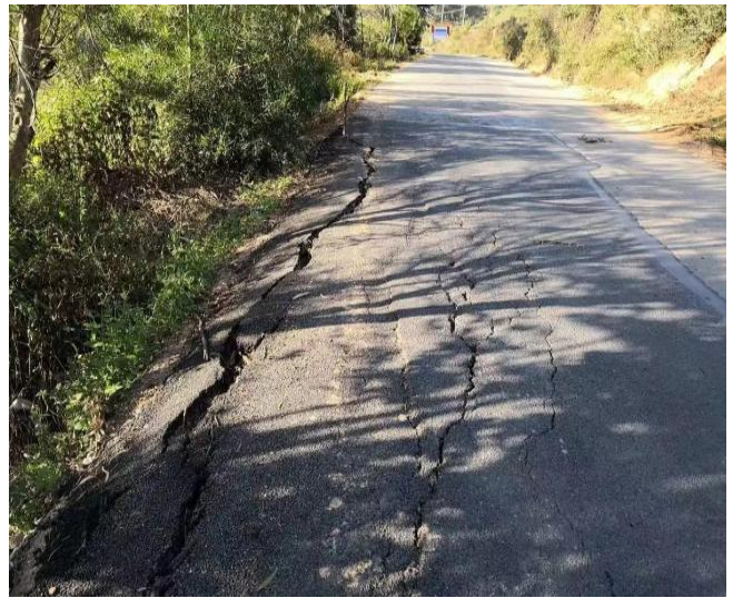
图1 路基塌陷、裂缝
