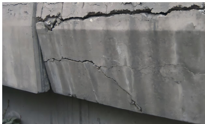
图1 某桥梁混凝土裂缝
