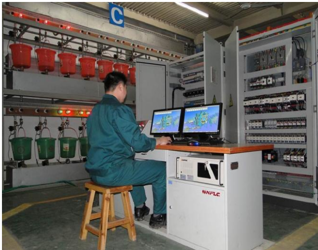
图一 PLC 智能化控制
