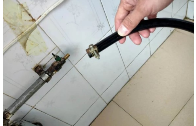
图1 户内燃气橡胶软管脱落示意图
