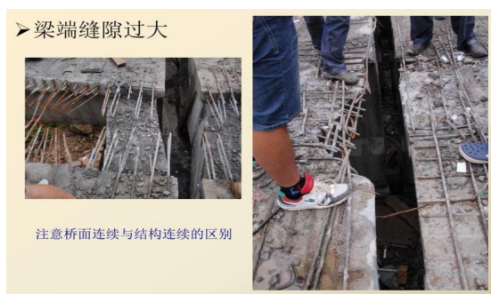
图 1：梁端缝隙过大
