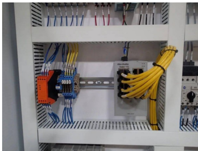
图1 配电柜内布线
