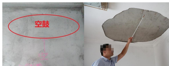
图 4.2 墙体空鼓、抹灰层脱落
