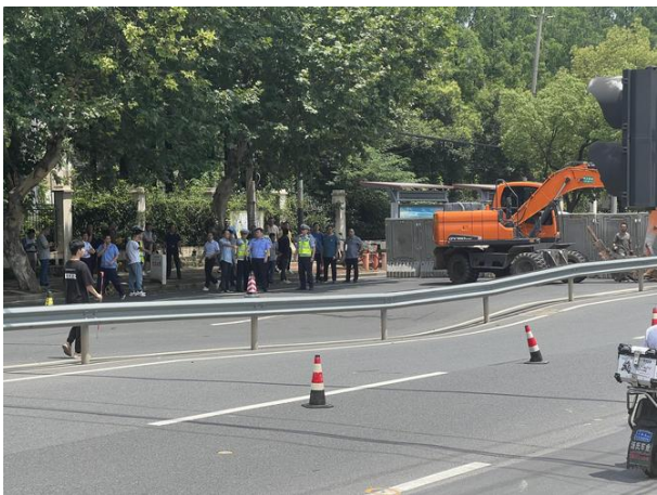
图1 道路不均匀沉降
