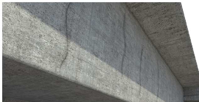
图1 道路桥梁裂缝
