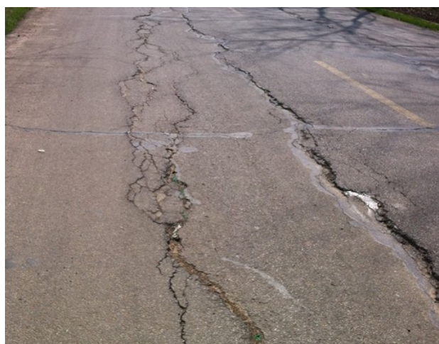
图1 道路路基不均匀沉降
