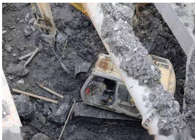
图1 深基坑施工安全隐患
