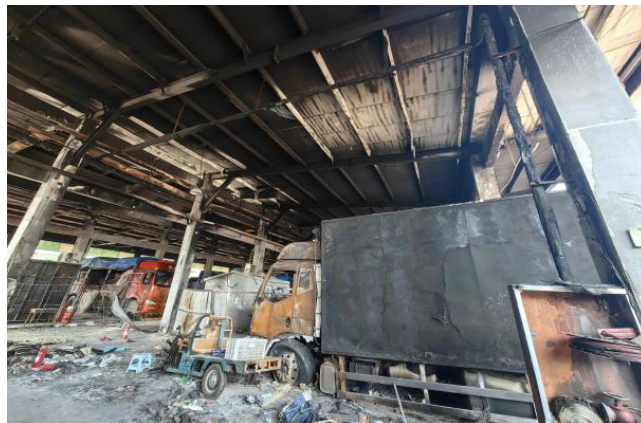
图2 火灾后现场实景图
