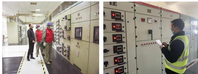
图1 电气工人在巡检电气系统运行状况图
