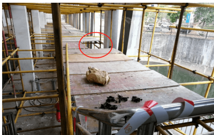
图1 脚手架安全隐患
