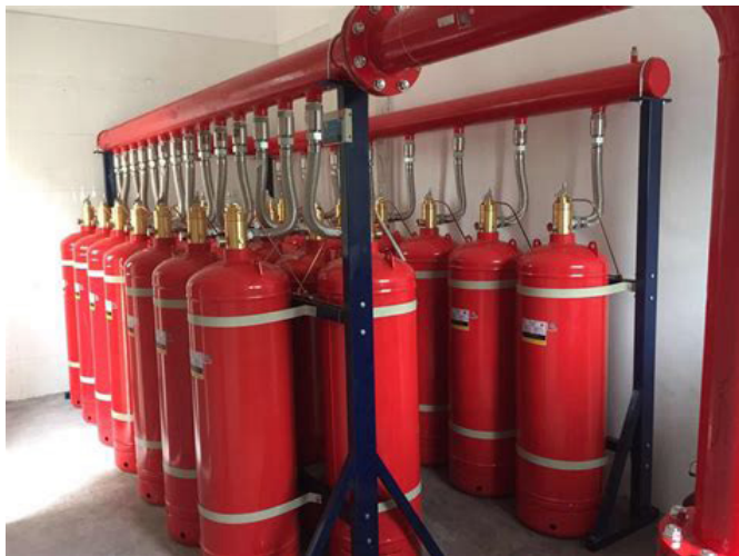
图1 气体灭火系统冲压测试器械图
