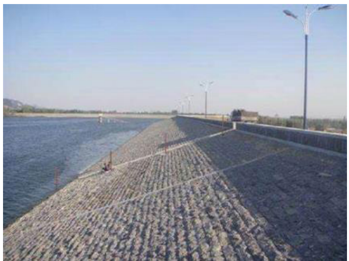
图1 堰坝过度冲刷
