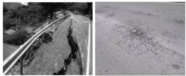
(a) 裂缝贯穿 (b) “蜘蛛网”路面
