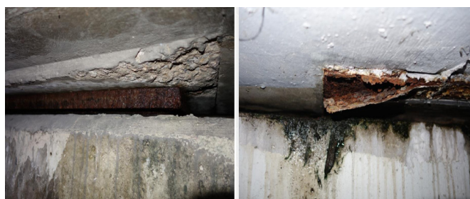
图2 某桥梁支座垫板锈蚀、离空病害
