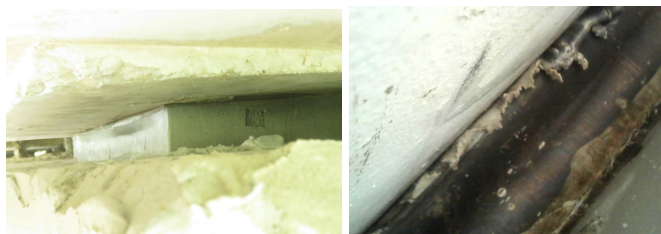
图1 某桥梁支座剪切鼓包病害
