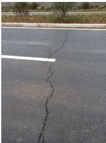
图2 沥青路面纵向裂纹
