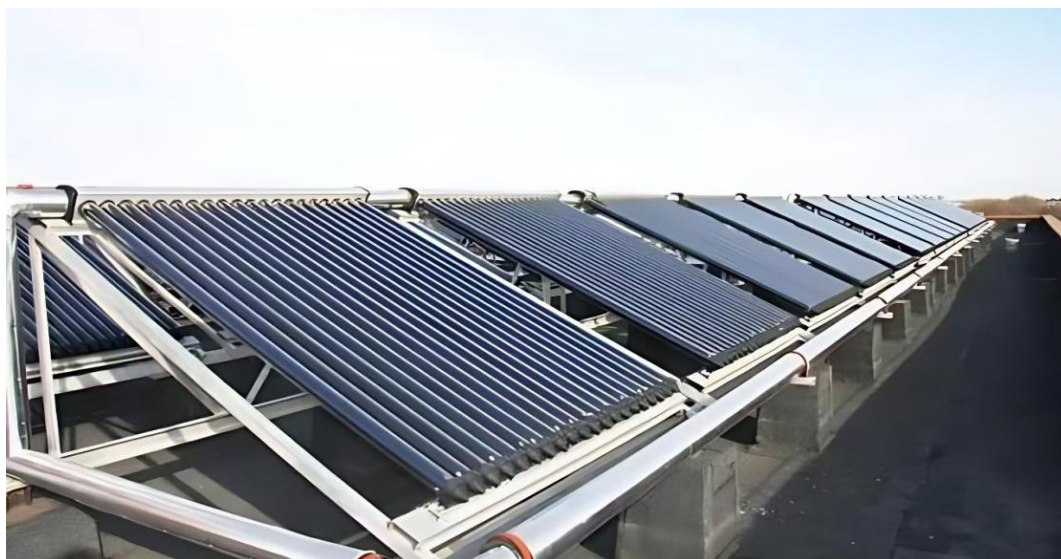
图 1 太阳能热水工程
