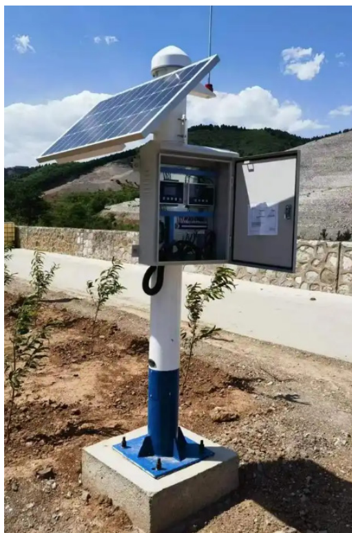
图1 水库安全监测系统
