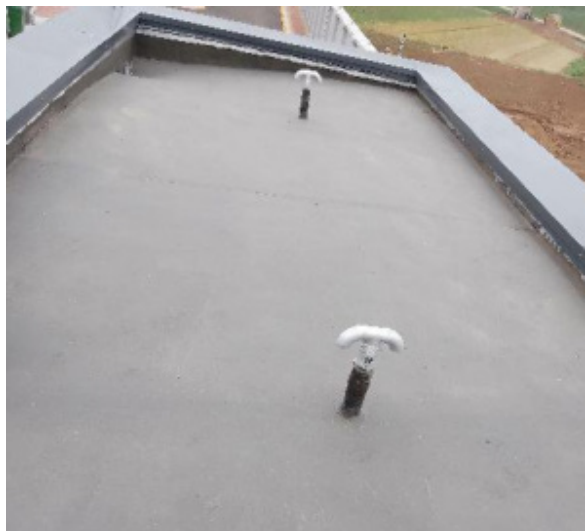
图2 变电站土建工程雨篷防水屏障现场图
