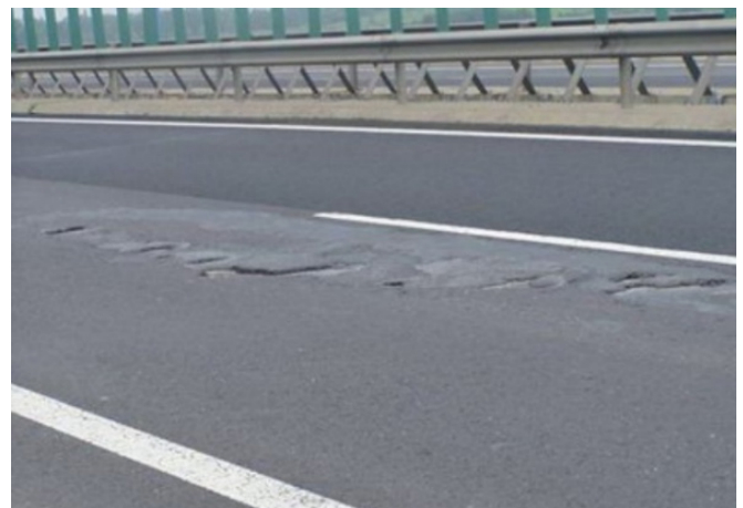
图一：桥面病害
