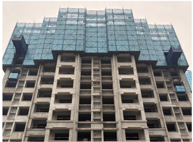
图3 爬架双卸料平台
