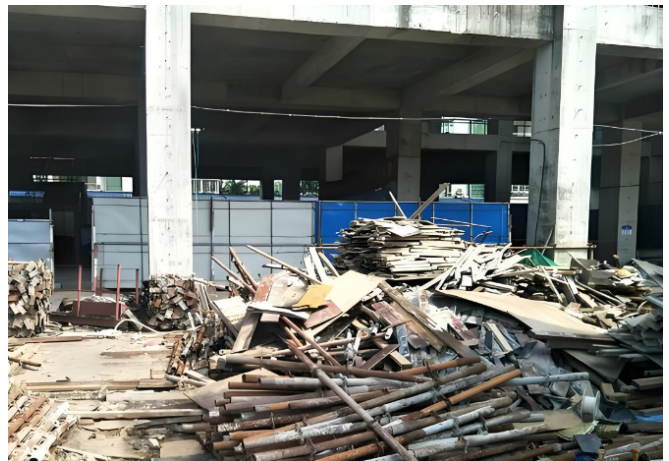
图1 建筑工地材料浪费
