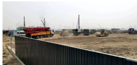
图1 施工现场灰尘大气污染
