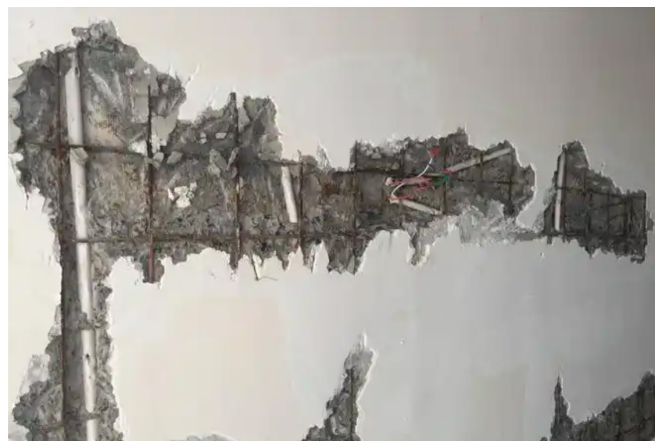
图 1：房屋钢筋锈蚀
