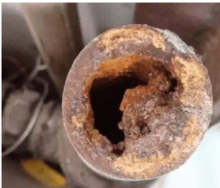
图1 管道老化与腐蚀
