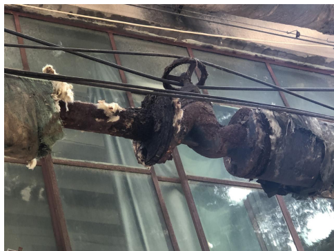
图 1 老旧小区供暖管道
