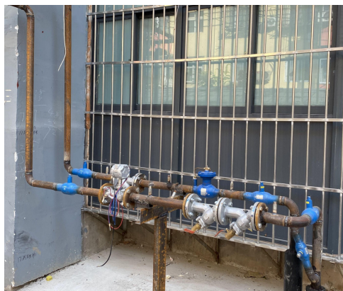
图 2 老旧小区供暖管道
