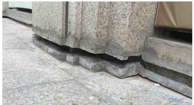
图一：地基下沉裂缝
