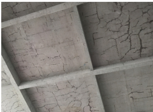
图1 高层建筑裂缝
