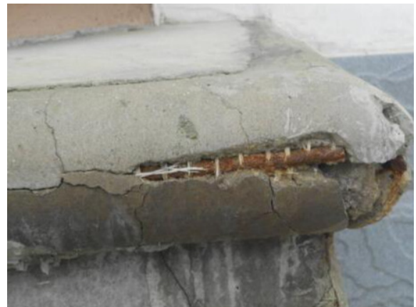
图2 混凝土碳化与钢筋锈蚀
