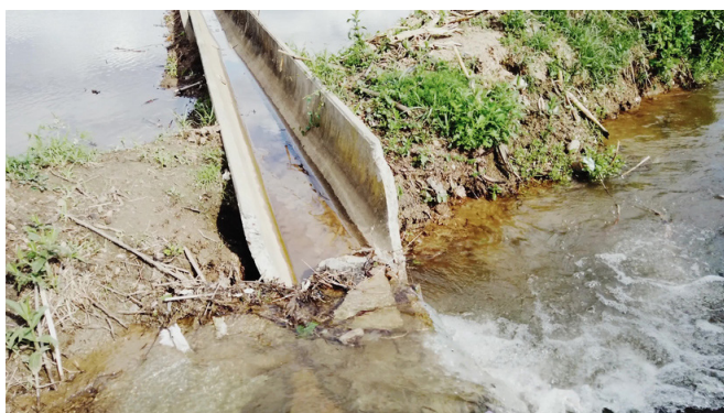
图一：渠道破损、老化
