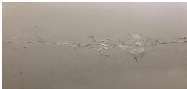
图1 某项目墙面起皮问题
