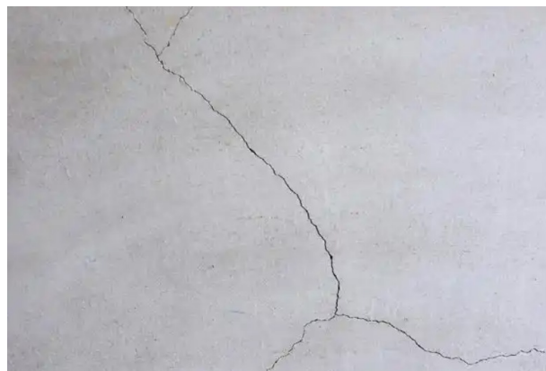
图1 混凝土表层裂缝
