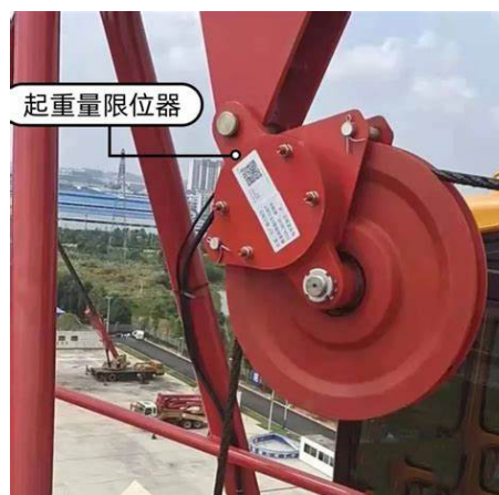
图一：塔式起重机起重量限位器
