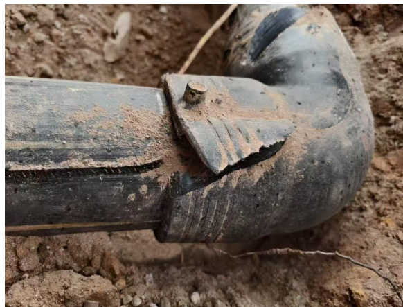
图1 城市燃气管道外力施工破坏
