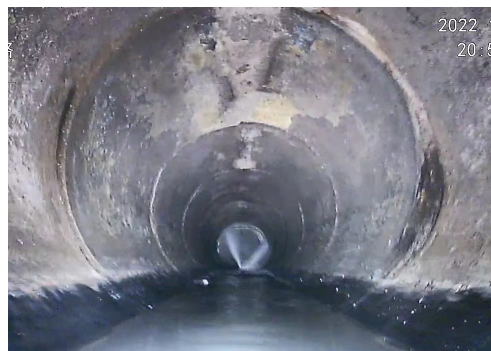
图 1 主管内部的损坏情况
