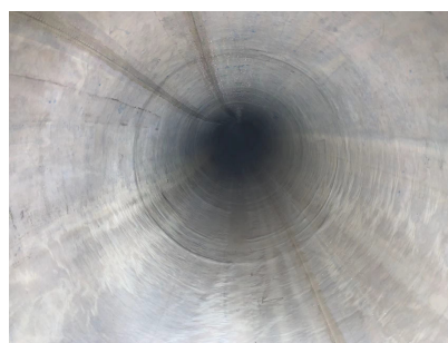
图 3 主管修复后的管内情况
