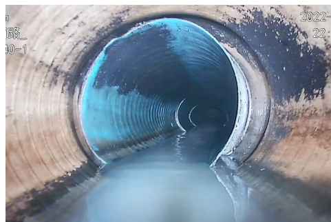
图 2 支连管内部的损坏情况
