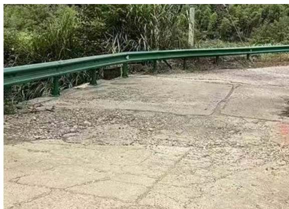
图 1 水泥混凝土路面坑洞现象
