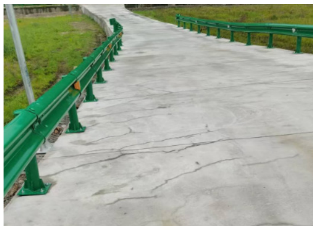
图 2 水泥混凝土路面塑性开裂现象
