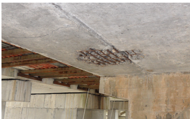
图2 钢-混组合梁桥面铺装层局部破损与脱落
