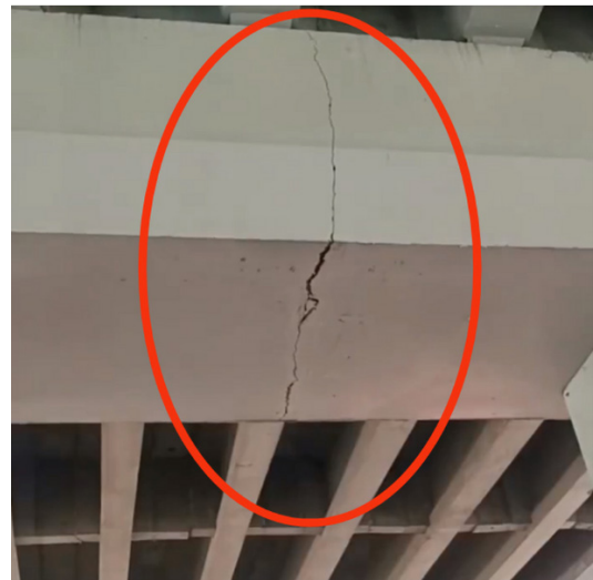
图1 钢—混组合梁桥面铺装层裂缝
