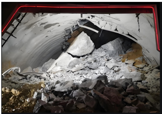
图1 隧道塌方现场
