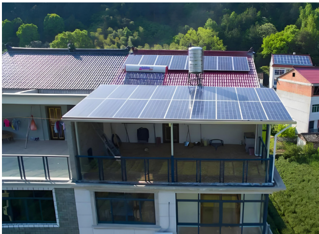
图1 屋顶光伏发电系统
