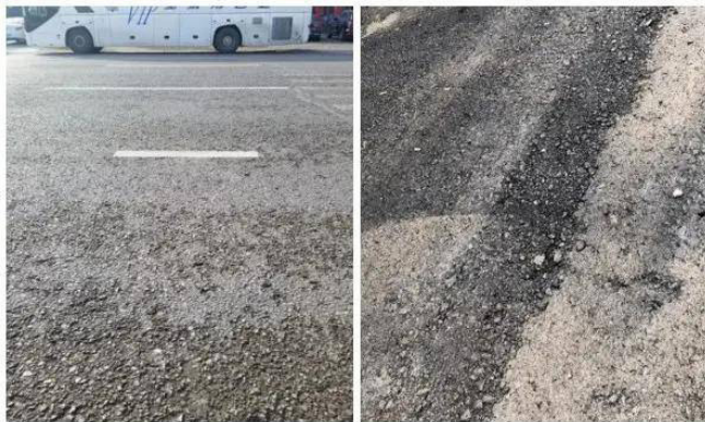
图2 公路沥青路面脱皮松散病害
