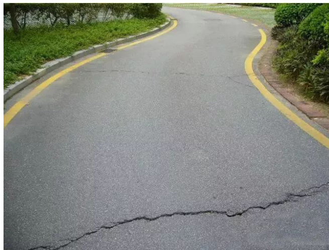
图1 公路沥青路面横向裂缝病害
