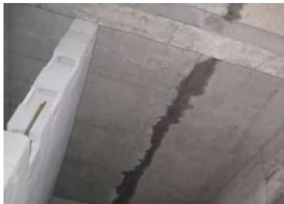
图一 建筑渗漏
