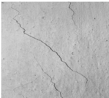
图1 混凝土楼板裂痕
