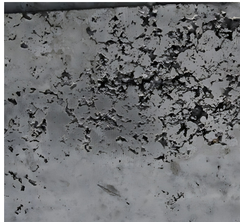
图 1 混凝土蜂窝麻面
