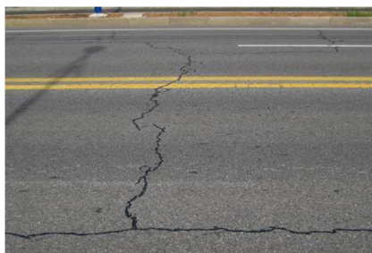
图1 道路横向裂缝图
