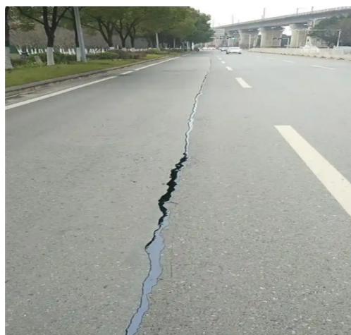
图2 道路纵向裂缝图
